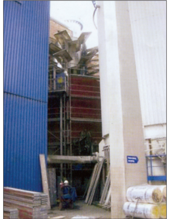
شکل ۱۸: فضای تنگ برای نصب برج دیفوزیون
